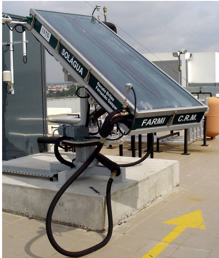
Fig. 4 – SolAgua CPC collector.
