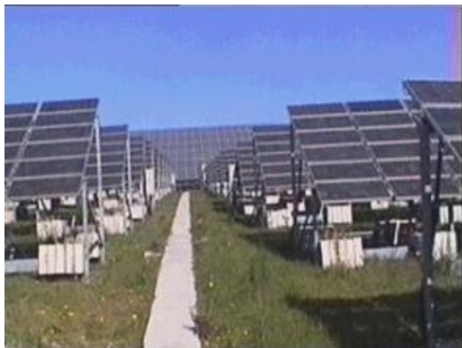
a) PV Generator
